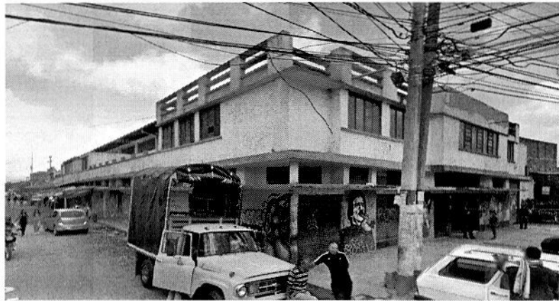
Ilustración 4. Estado estructura de la plaza de mercado del municipio de Soacha
